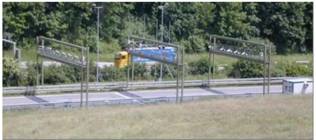
Suisse : Exemple d'une solution à trois portiques (1x 2 voies). Le troisième portique prend les photos de l'arrière de la remorque.
